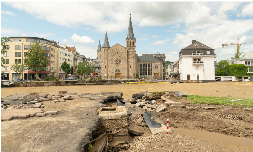
Abb. 03: Ausgespülte und beschädigte Infrastruktur nach dem Hochwasser 2021 [Foto: Dominik Ketz]
