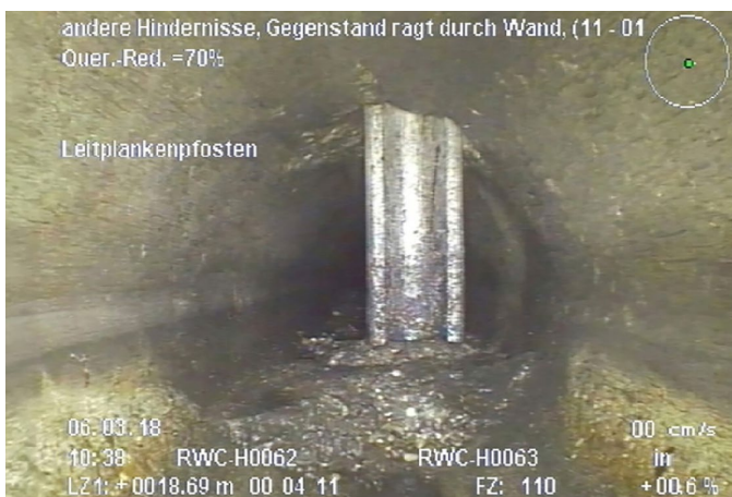
Abb. 02: Eingerammter Schutzplankenpfosten im Abwasserkanal
