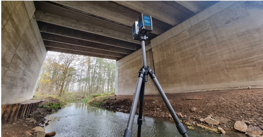
Abb. 04: Der terrestrische Laserscanner erfasst präzise 3D-Messpunktwolken und 360-Grad-Panoramen. Für den Laserscanner nicht zu erfassen sind höhere Ebenen, Hinterschneidungen und Winkelverschattungen, da er je nach verwendetem Stativ auf ca. 3 Meter Positionshöhe des Stativkopfs begrenzt ist. [Foto: F7 DIGITAL GmbH]
