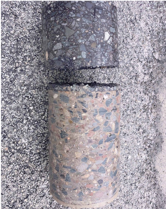
Abb. 01: Geprüfter Bohrkern, Abriss innerhalb der neuen Asphaltdecke
