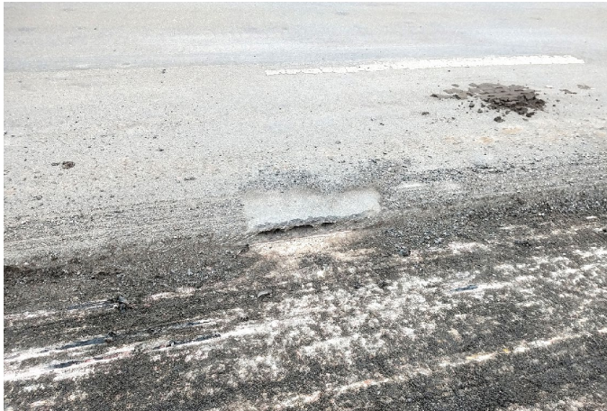
Abb. 02: Hohlräume im Asphaltbelag
