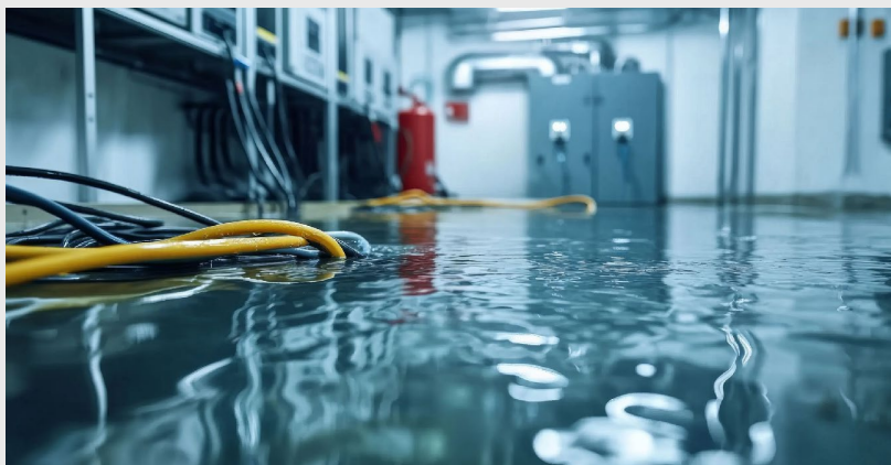
Abb. 01: Überflutetes Kellergeschoss nach Starkregenereignis [Foto: bauass Versicherungsmakler GmbH & Co. KG]
