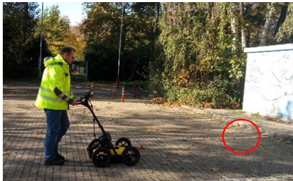
Abb. 01: Leitungsverlauf mit Schieber (roter Kreis) [Foto: ArborPlan GmbH & Co. KG]
