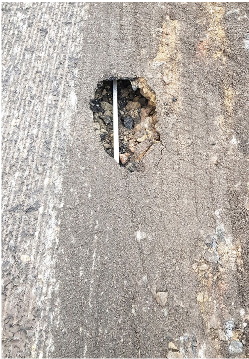
Abb. 01: Abgesackter Bereich der Fahrbahndecke
