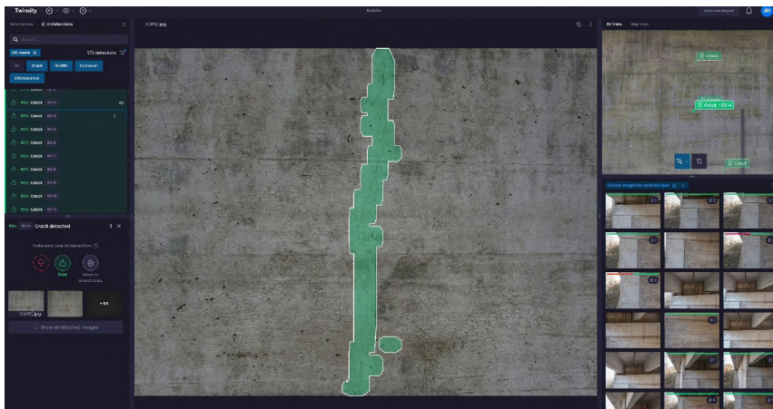
Abb. 10: Die automatische KI-basierte Schadenerkennung liefert präzise Ergebnisse. [Quelle: F7 DIGITAL GmbH]
