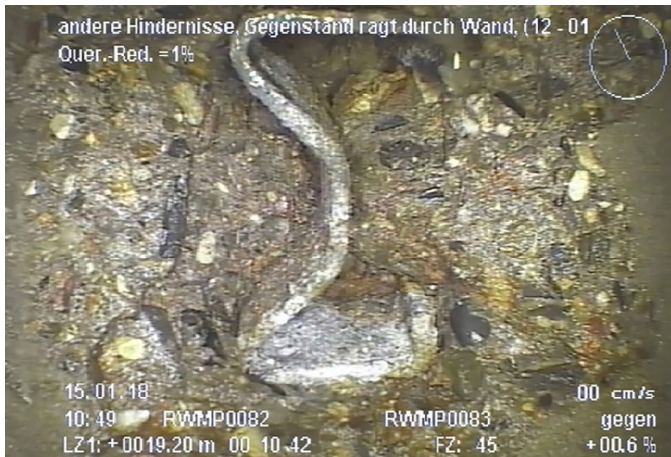
Abb. 01: Metallprofil in der Rohrwand des Abwasserkanals
