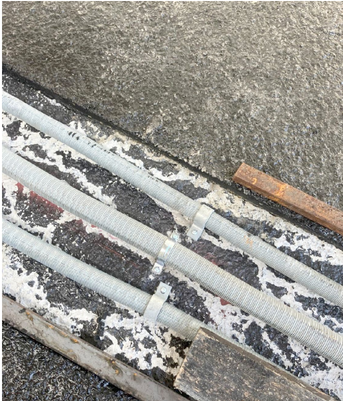
Abb. 02: Durch Verschraubungen perforierte erste Abdichtungsebene; die weiße Färbung wurde von der beim Bohren anfallenden Betonschlämme verursacht
