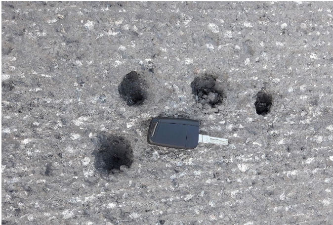
Abb. 04: Hohlräume im Asphaltbelag nach dem Abfräsen der Blasen
