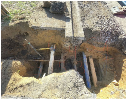
Abb. 05: Leitungskörper nach Anlage eines Querschlags [Foto: ArborPlan GmbH & Co. KG]
