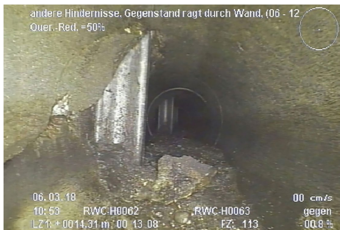
Abb. 04: Durch das Einrammen beschädigtes Kanalrohr
