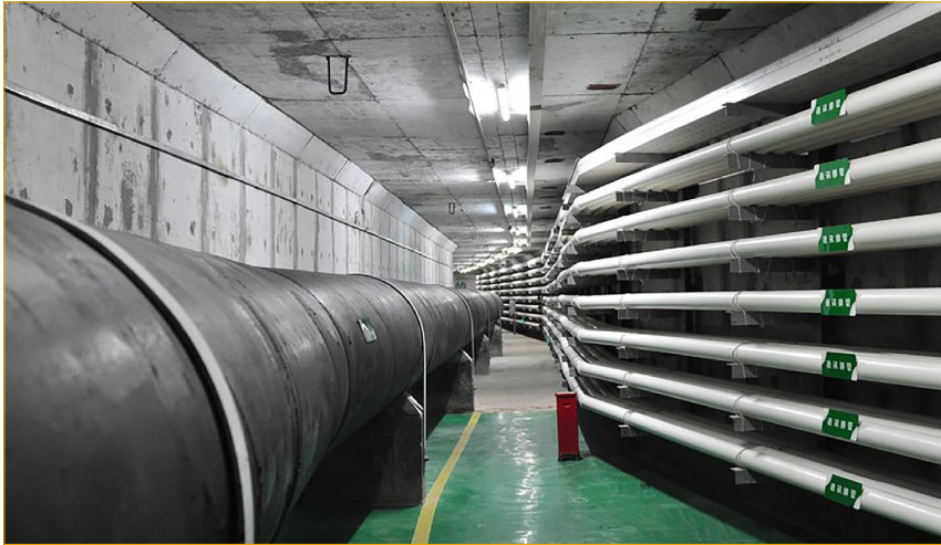
Abb. 09: Leitungskanal in Hengqin [Foto: © China Org. CN 26 ]
